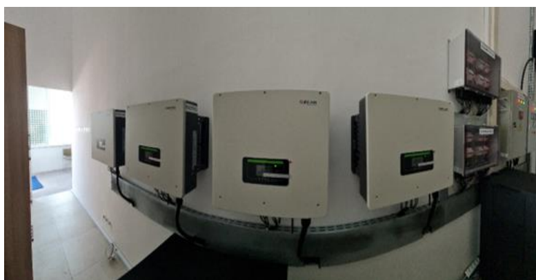
Gambar 59. Ruang kontrol PLTS di belakang tribun gedung Merah Putih
