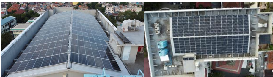
Gambar 57. Tampak atas PLTS BPOM
